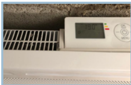
Photo du radiateur fixé au mur en état de marche (ne pas le posé au sol)
