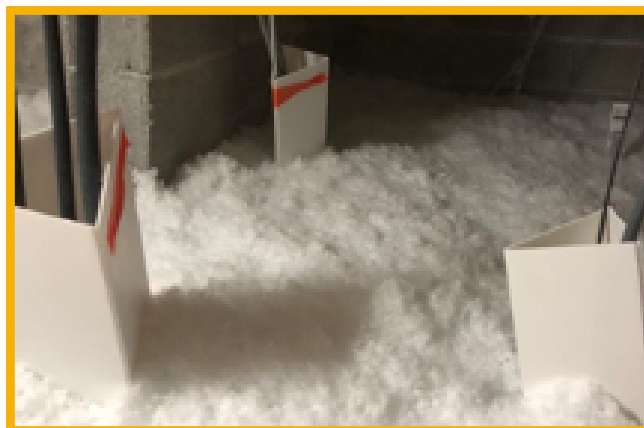
Écart au feu autour des fils électriques + photos
