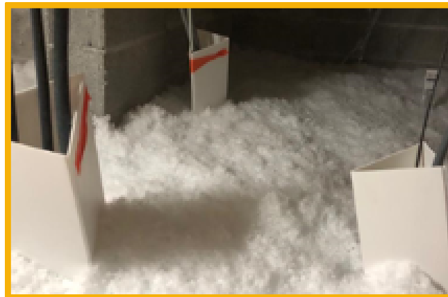
Distanța față de foc în jurul firelor electrice + fotografii
